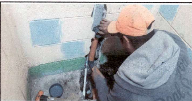
Foto 5. Servicios Sanitarios y sus accesorios
